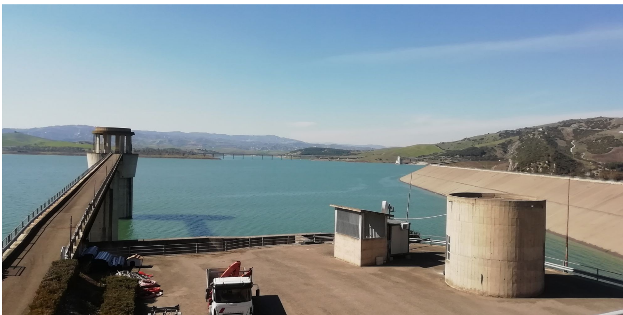
Figura 14: Vista del gruppo elettrogeno.
